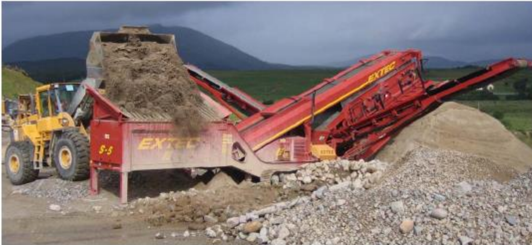
Figura C.3. Immagine rappresentativa dell'attività dell'impianto di vagliatura (foto da manuale impianto)
